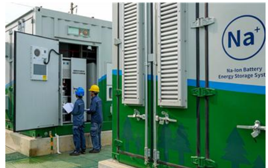
ระบบกักเก็บพลังงาน “แบตเตอรี่โซเดียมไอออน” (Sodium-Ion Battery) ความจุสูง
